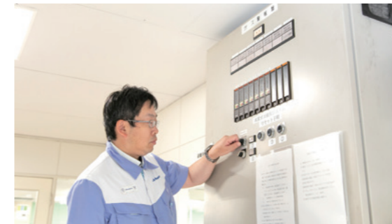
水素ガス漏れ検知器点検
