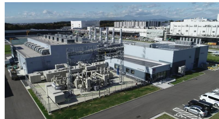
清原スマートエネルギーセンター
