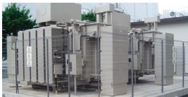
特高受電設備
