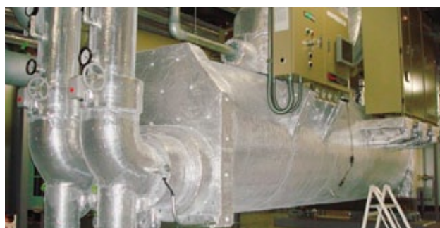
ターボ冷凍機
