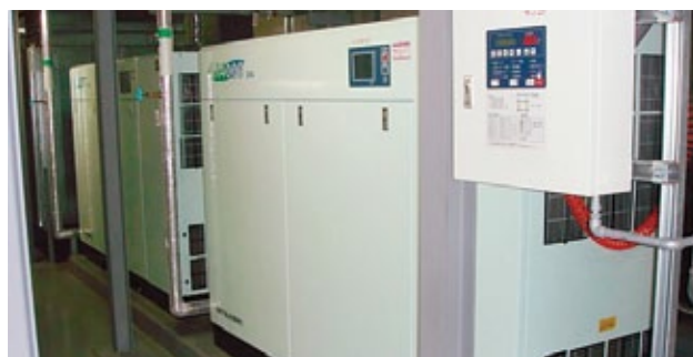
台数制御コンプレッサー
